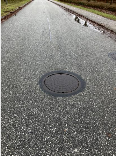
Billede 5: Dæksel på Østermarksvej der ligger for lavt.
